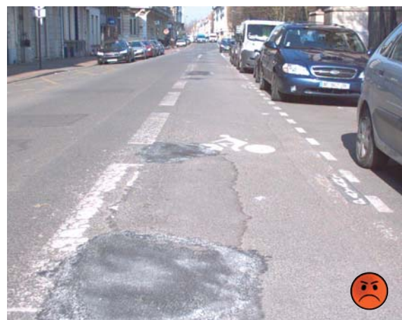
Revêtement dégradé pénalisant la circulation du cycliste
